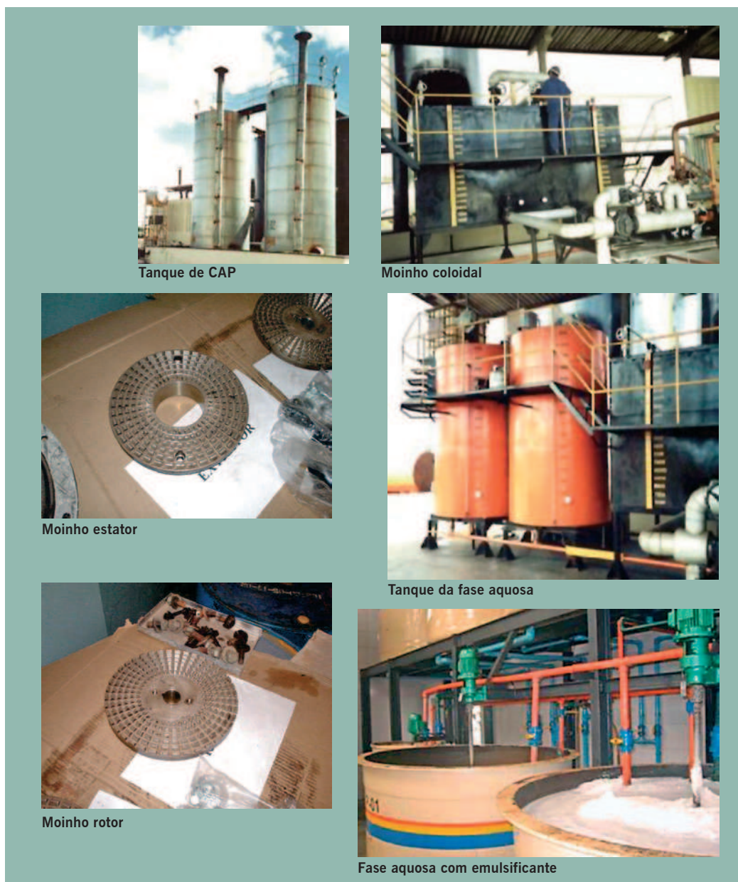
Figura 2.37 Exemplos de várias instalações de uma fábrica de emulsão
