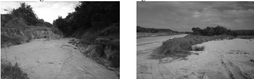
Figura 4 – assoreamento as margens da rodovia BR-101
