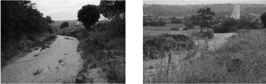
Figura 3 – detalhe assoreamento e desestabilização de taludes laterais
