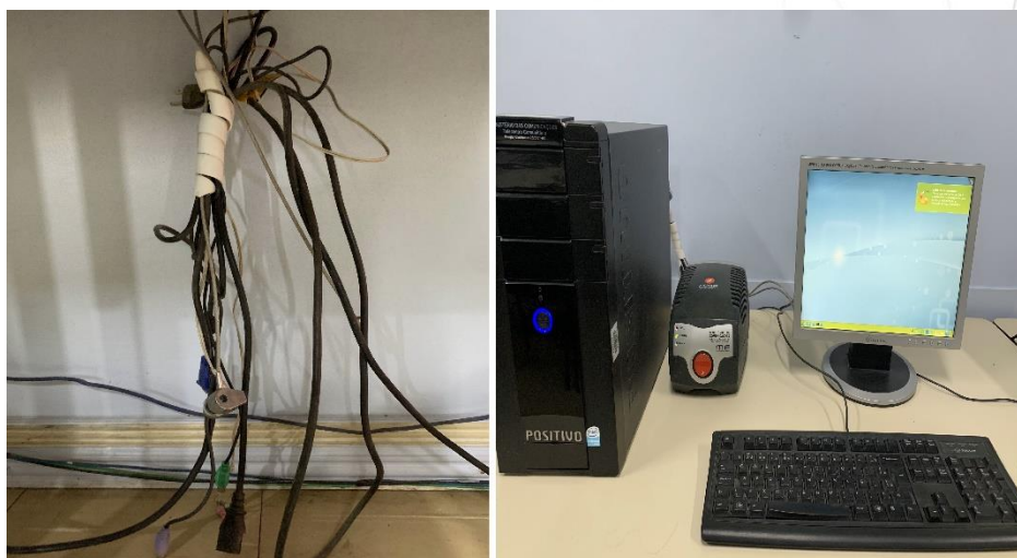
Figura 5 – Cabeamento desconectado de uma máquina inativa e após a máquina já em funcionamento, respectivamente.
